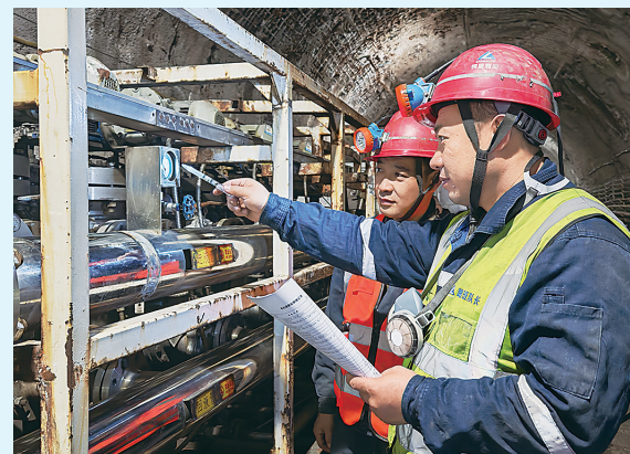
►图为银星煤业综采一队员工在井下检查乳化泵站设备运行情况。周熙昊 摄
