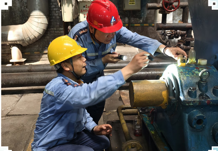
图为山西新材料员工检查设备运行状况。
